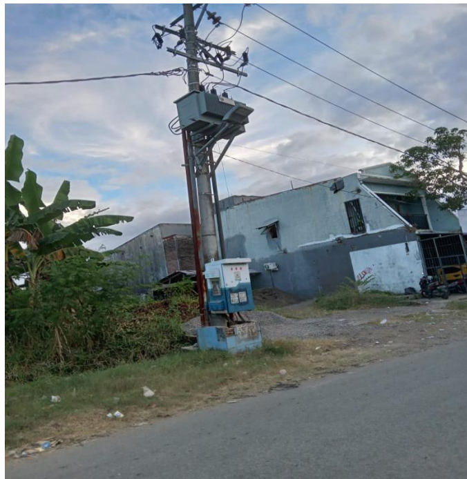
Gbr 3. Contoh Konstruksi Gardu Cantol
